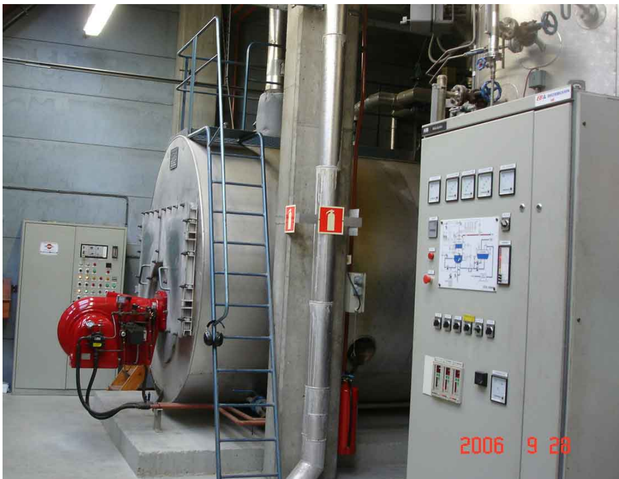
Figur 2-1, Oljedampkjel og eldampkjel i fyrsentralen som er på ca 10x13 meter.
